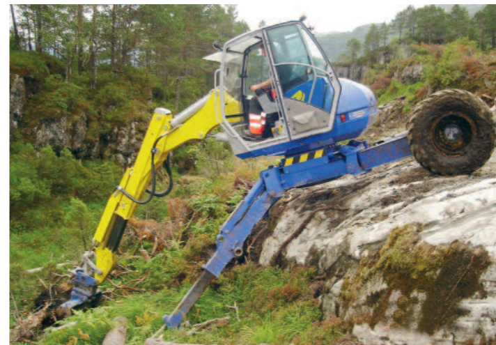
Maskinfører Roar Nyvoll i gang med rensking av skogbunnen på det nye feltet hos Oster Pukk.
